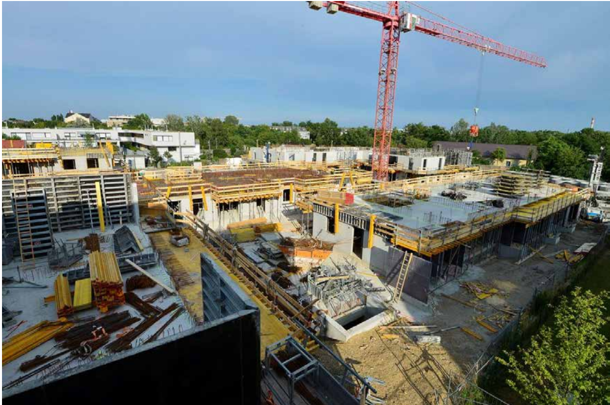
Bild 1: In der Mühlgrundgasse entsteht das erste soziale Wohnbauprojekt mit Thermischer Bauteilaktivierung (TBA) zum Heizen und Kühlen.
