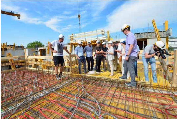
Bild 5: Hier sind die Rohrregister zu sehen, in denen je nach Heiz- oder Kühlzweck warmes oder kaltes Wasser fließen wird. Im Hintergrund erläutert Andrea Kuster das innovative System.
