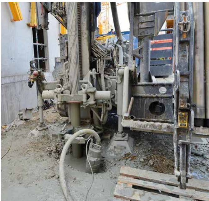
Bild 4: Erneuerbare Energiequellen in Kombination mit Beton: Mit insgesamt 30 Erdsonden wird Geothermie über Niedertemperatursysteme effizient genutzt.
